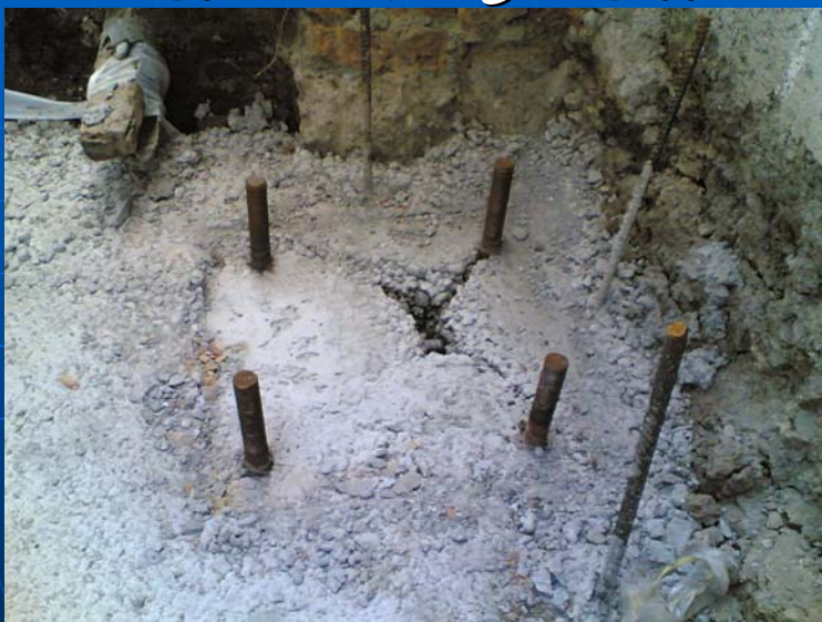
فضای خالی زیر کف ستون
