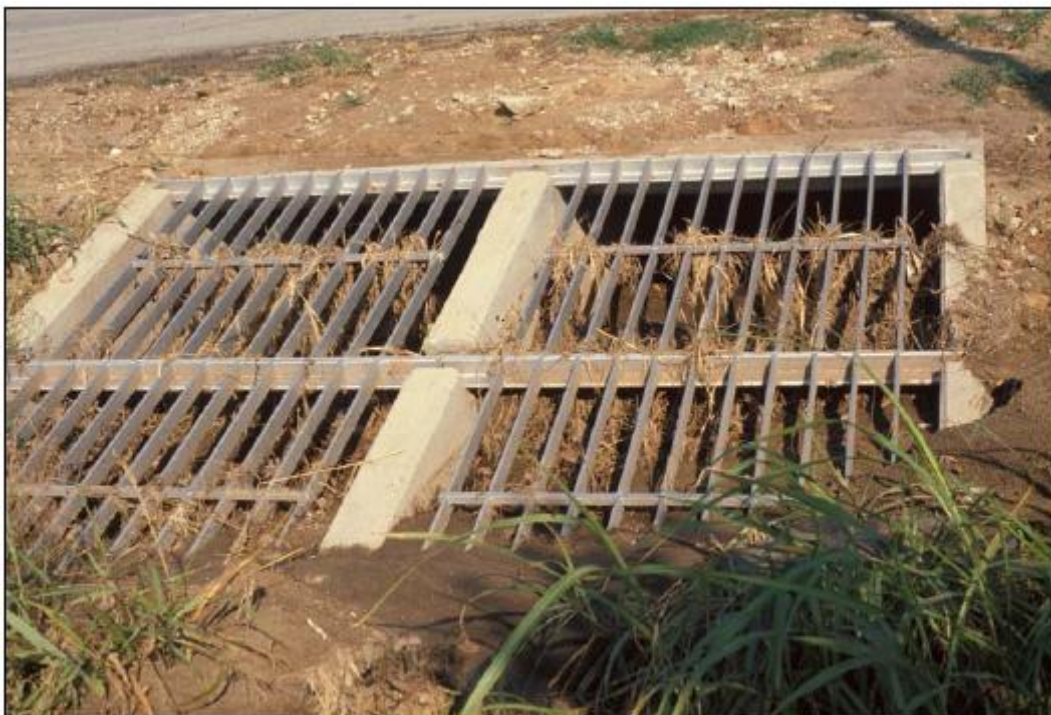
شکل 1-4- تجمع آشغال در دهانه ورودی آبرو و روی شبکه آشغالگیر
