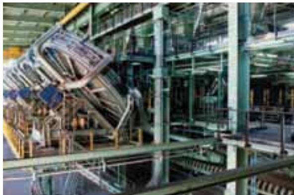
شکل ۵-۲- دیسکهای گندله سازی وظیفه تولید گندله خام (Pellet Green) و یا شکل دهی کروی گندله را به عهده دارند. تعداد ۸ عدد دیسک در دو ردیف چهارتایی هر یک به قطر ۷/۵ متر در شرکت فولاد مبارکه وجود دارد.
