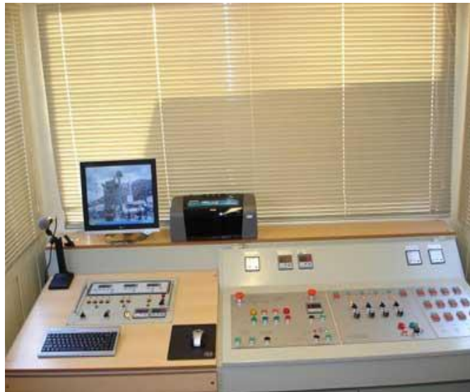
شکل (۵-۲۷): کابین کنترل کارخانه آسفالت
