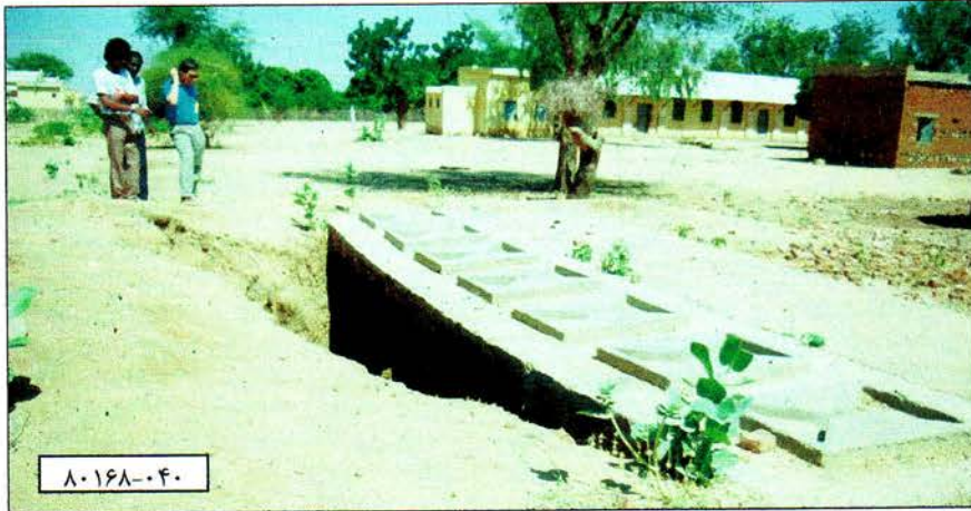
شکل ۵-۶: نمونه از ریزش یک چاهک توالت بدون پوشش داخلی
