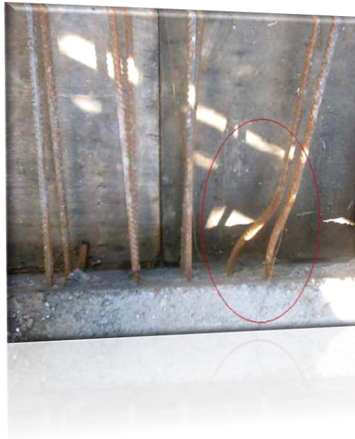
عدم دقت در گذاشتن میلگرد برای راه پله و خم شدن نامناسب آن
