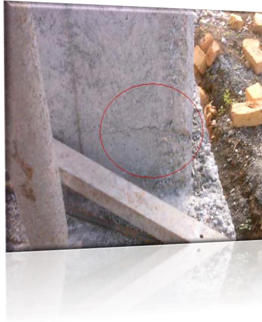
ترک خوردن ستون که باعث ضعف بتن میشود
