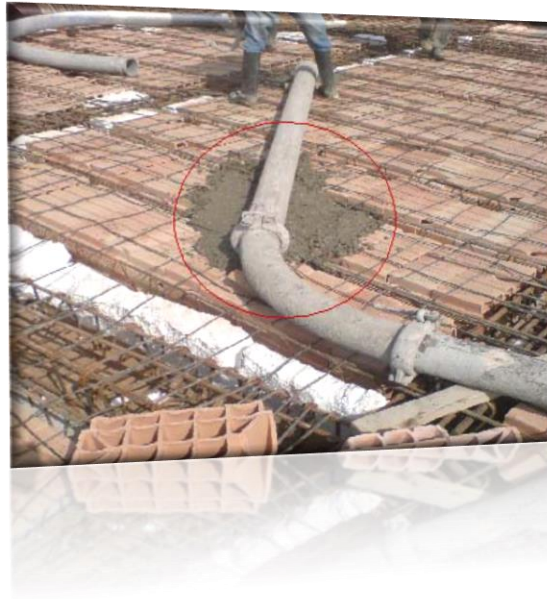
ابتدای نامناسب لوله های بتن ریزی و جمع شدن بتن در محل
