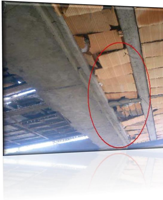
استفاده از بلوکهای نامناسب و نفوذ بتن به داخل آنها
