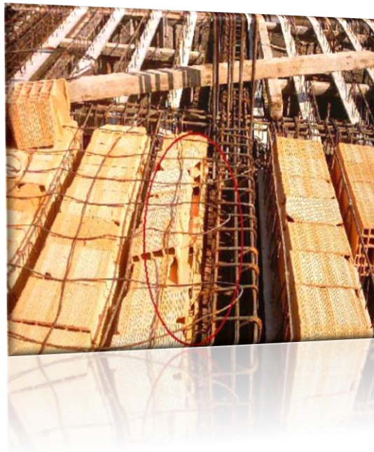
استفاده از بلوکهای شکسته که منجر به نفوذ بتن به داخل بلوک میشود
