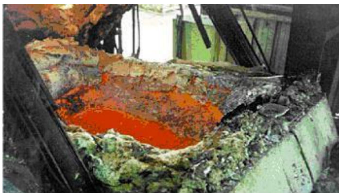
شکل : کوره ذوب آلومینیم با پوشش داخلی نسوزهای آلومینائی (تجمع دراس و نیز خوردگی نسوز)
