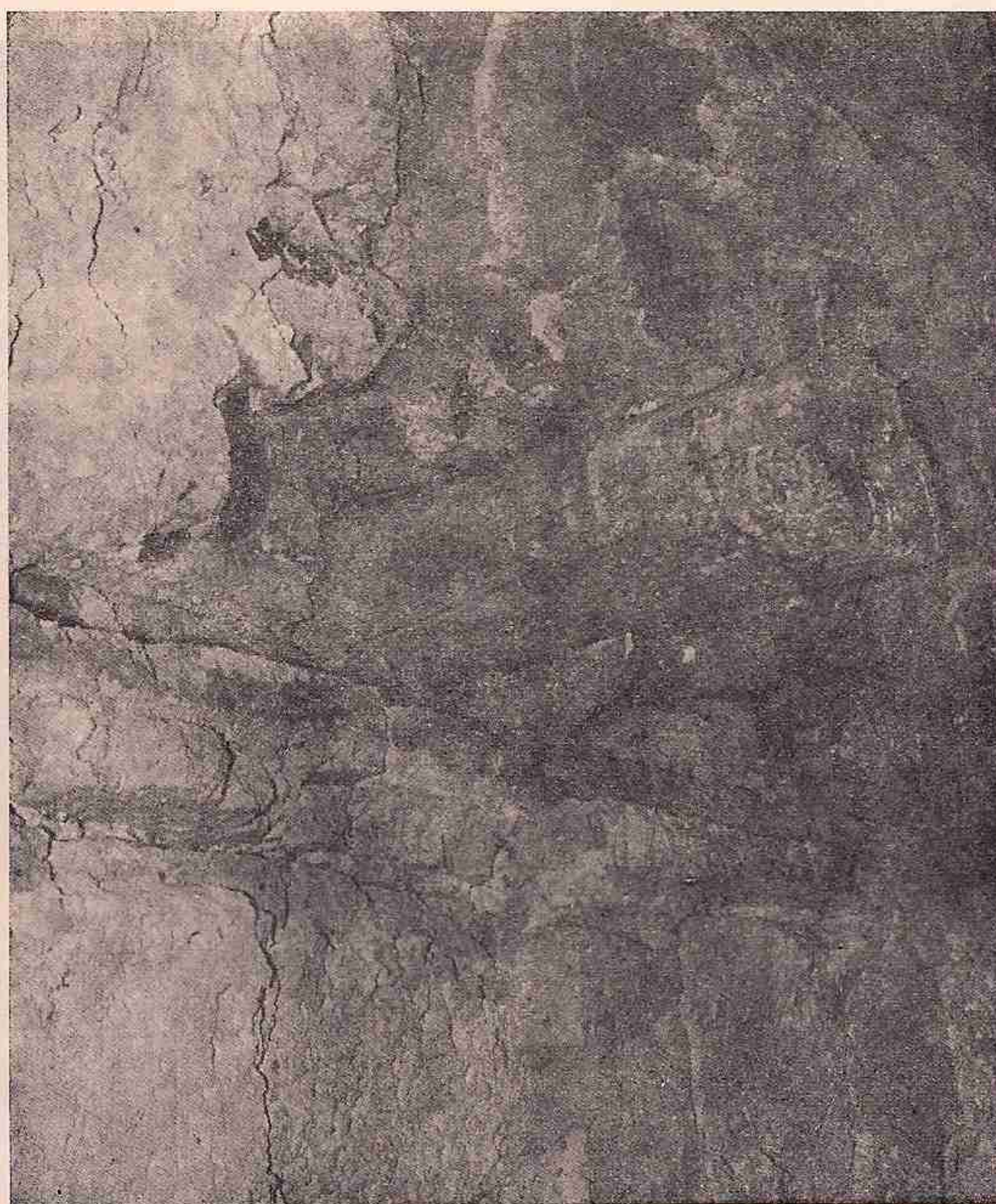
۳۳ - سلطانیه - ساختمان داخل گنبد - علائم باقیمانده از چوبهای داربست
