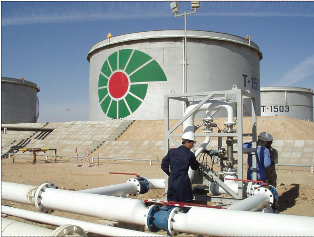
شکل ۳ | نمونه نصب شده دستگاه در واحد بهره‌برداری
