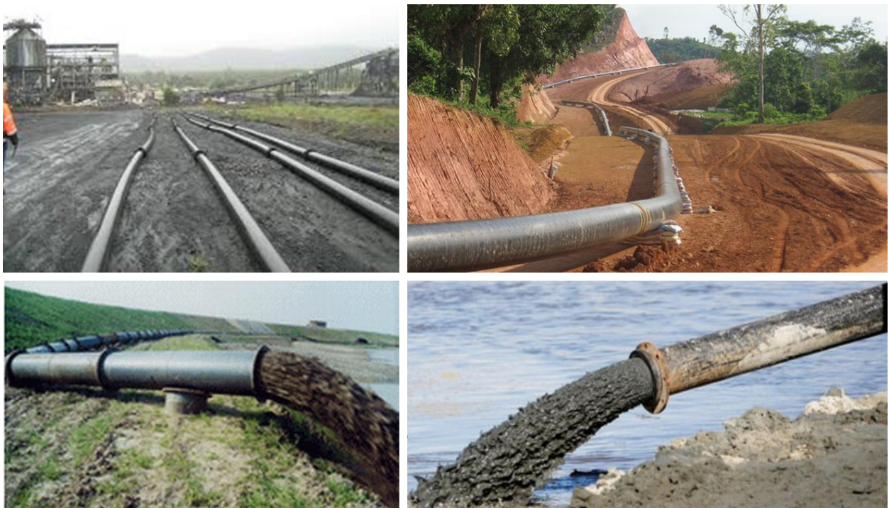
شکل ۷-۲۱: لوله های بسیار طولانی (تا ۵۰۰ کیلومتر) برای انتقال کنسانتره آهن، مس و ذغال
