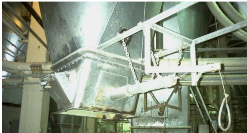
شکل ۴-۴۰: فلنج های نصب شده در انتهای قیف خروجی
