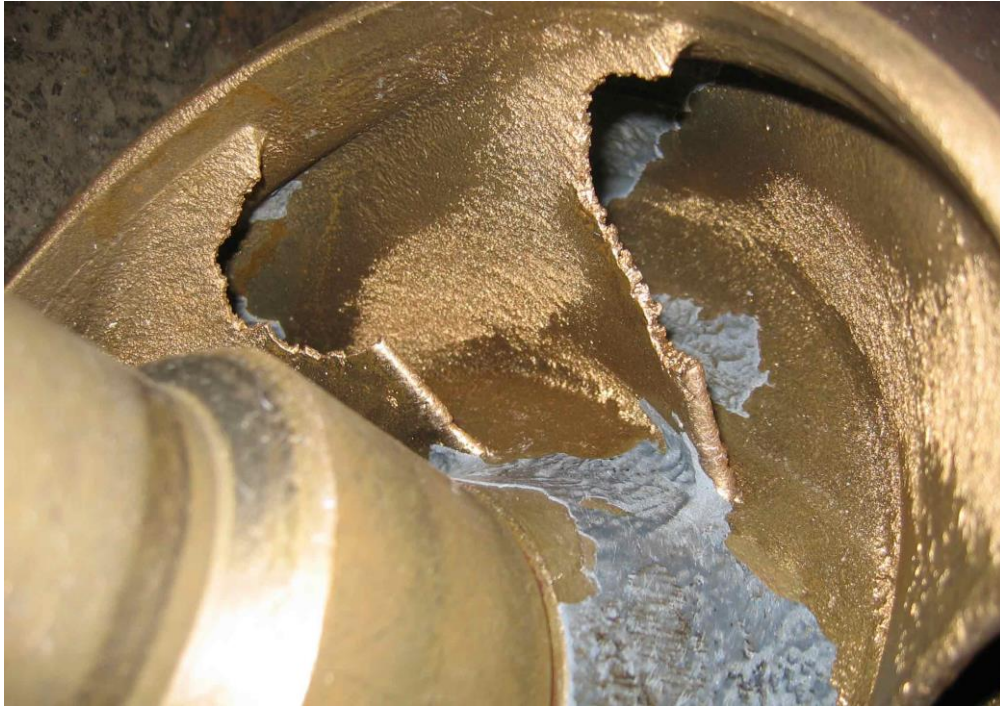
شکل ۷-۹: سایش در پمپ در اثر پدیده کاویتاسیون
