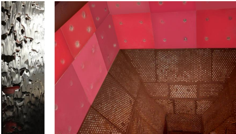
شکل ۴-۲۰: آسترهای نصب شده در بدنه مخزن برای جلوگیری از سایش آن
