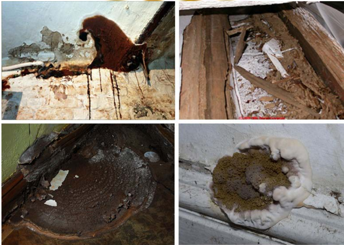
تخریب چوب های ساختمان از طریق انواع قارچها
