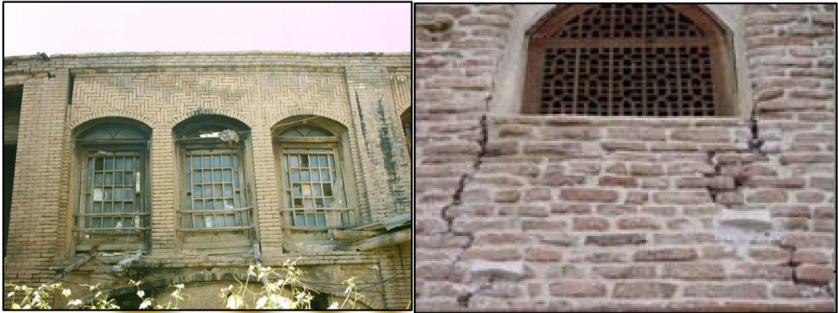
انواع ترک بر اثر نشست پی:
