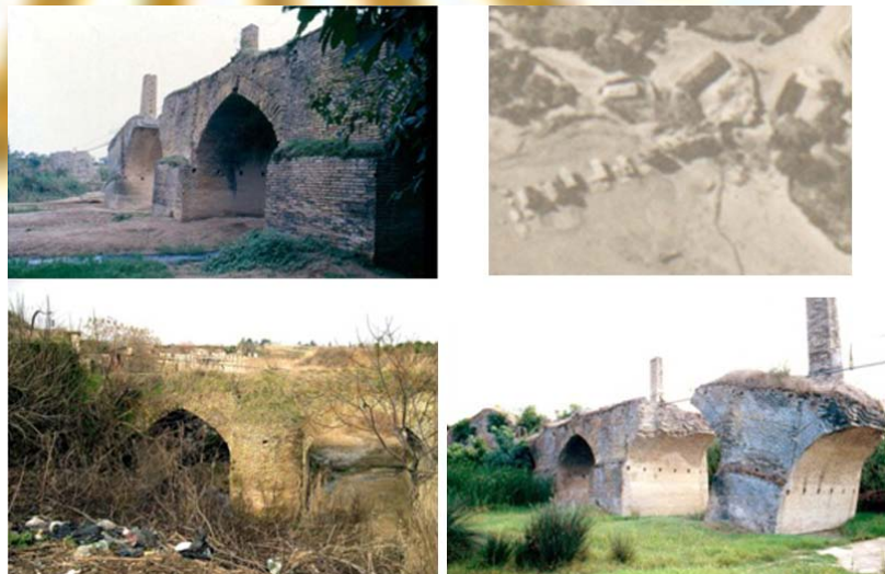
روند تخریب پل فرح آباد بر اثر نشست
