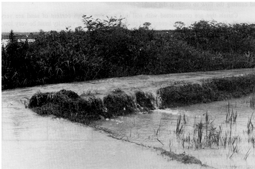
شکل ۲۵. سرریز آب از دیواره‌ی کانال
