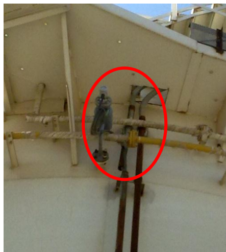
نمونه ای از level switch نصب شده روی یکی از مخازن
