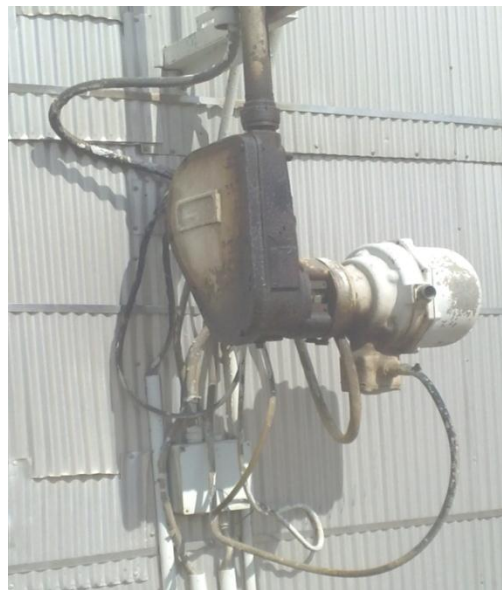
لول سطح فلوتری نصب شده روی یکی از مخازن موجود در پالایشگاه
