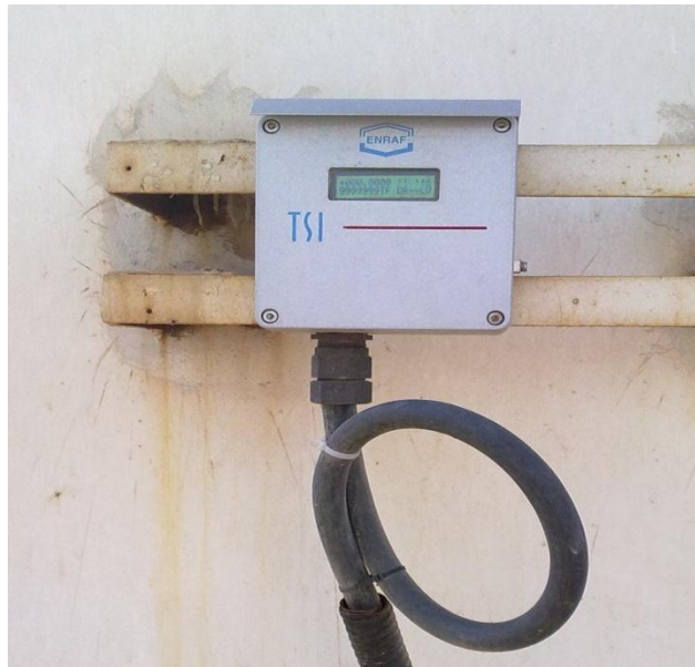
آلتراسونیک لول سنج نصب شده روی یکی از مخازن موجود در پالایشگاه
