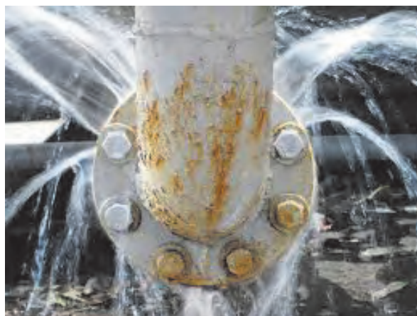
شکل ۲۴-۵. نشت آب بر اثر ضربه قوچ
