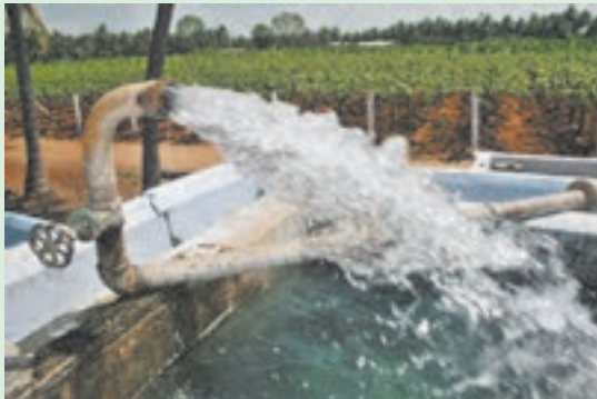
شکل ۳۰-۵. لوله برگشت آب
