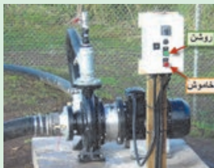
شکل ۲۸-۵. کلیدهای کنترل روی تابلو
