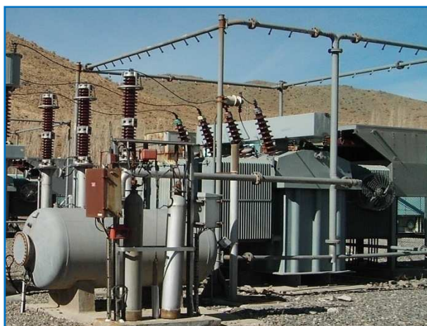
شکل ۹-۱ ترانسفورماتور قدرت فشارقوی با توان ۳۰ MVA و ولتاژ KV ۱۱ / ۶۳
