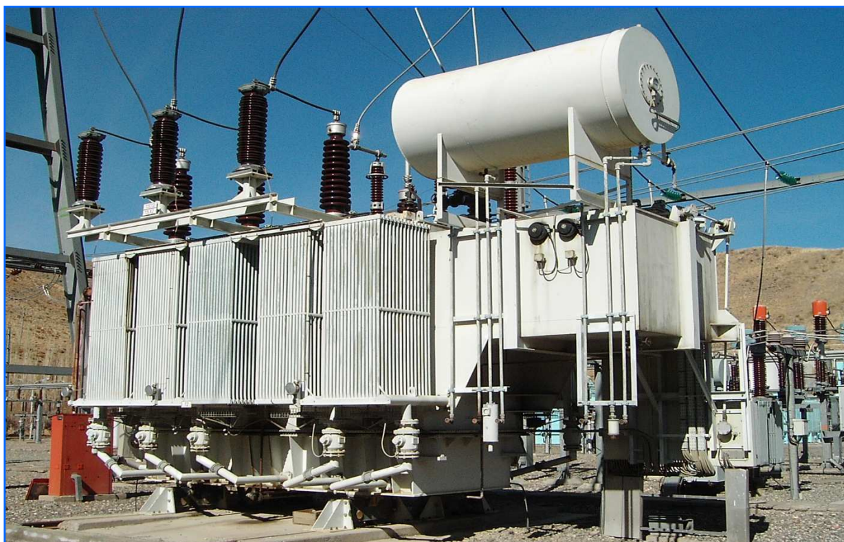
شکل ۱-۱۱ اتو ترانسفورماتور با قدرت نامی 160 MVA با ولتاژ KV ۱۳۲/۶۳/۲۰
