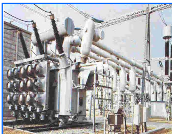
شکل ۸-۱ اتوترانسفورماتور قدرت فشارقوی با توان ۶۰۰ MVA و ولتاژ KV ۲۳۰ / ۴۰۰
