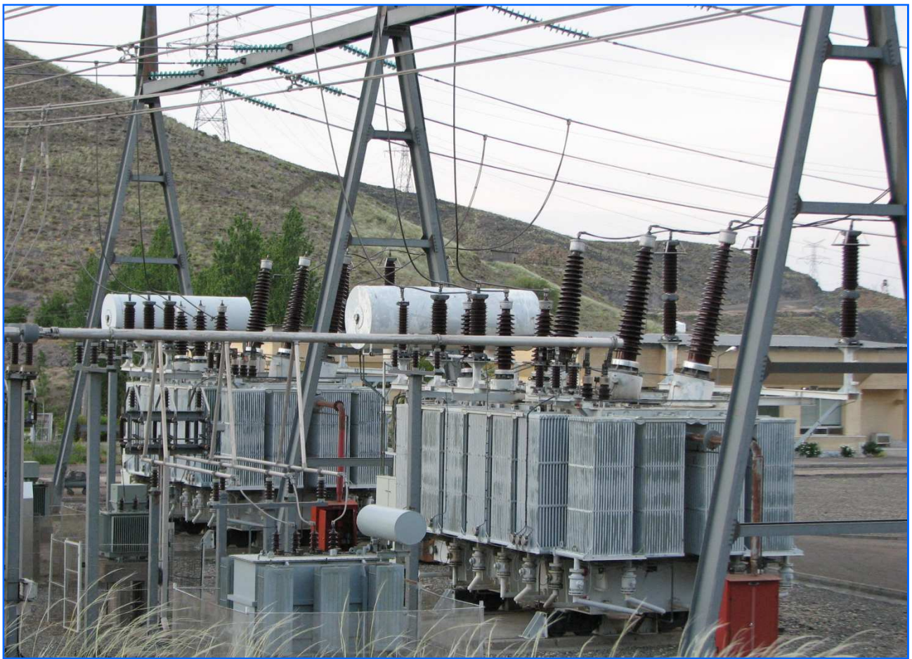
شکل ۱۳-۱ اتوترانسفورماتور با قدرت نامی 240 \text{ MVA} و ولتاژ 230 / 132 / 20 \text{ KV}
