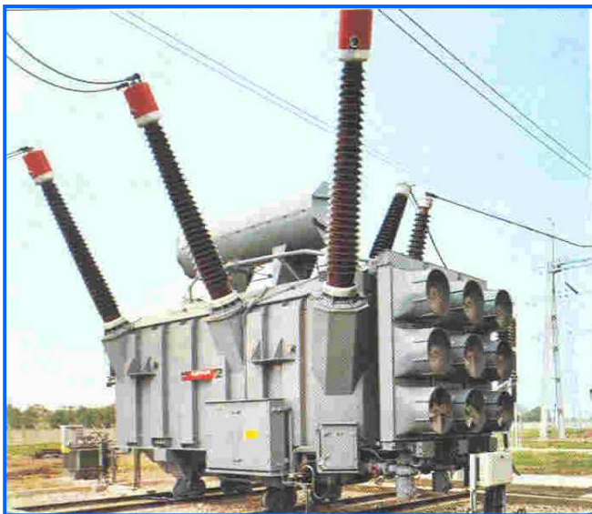
شکل ۷-۱ اتوترانسفورماتور قدرت فشارقوی با توان ۳۰۰ MVA و ولتاژ KV ۲۳۰ / ۴۰۰
