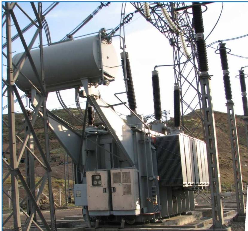
شکل ۱۴-۱ ترانسفورماتور با قدرت نامی 125 \text{ MVA} و ولتاژ 230 / 20 \text{ KV}
