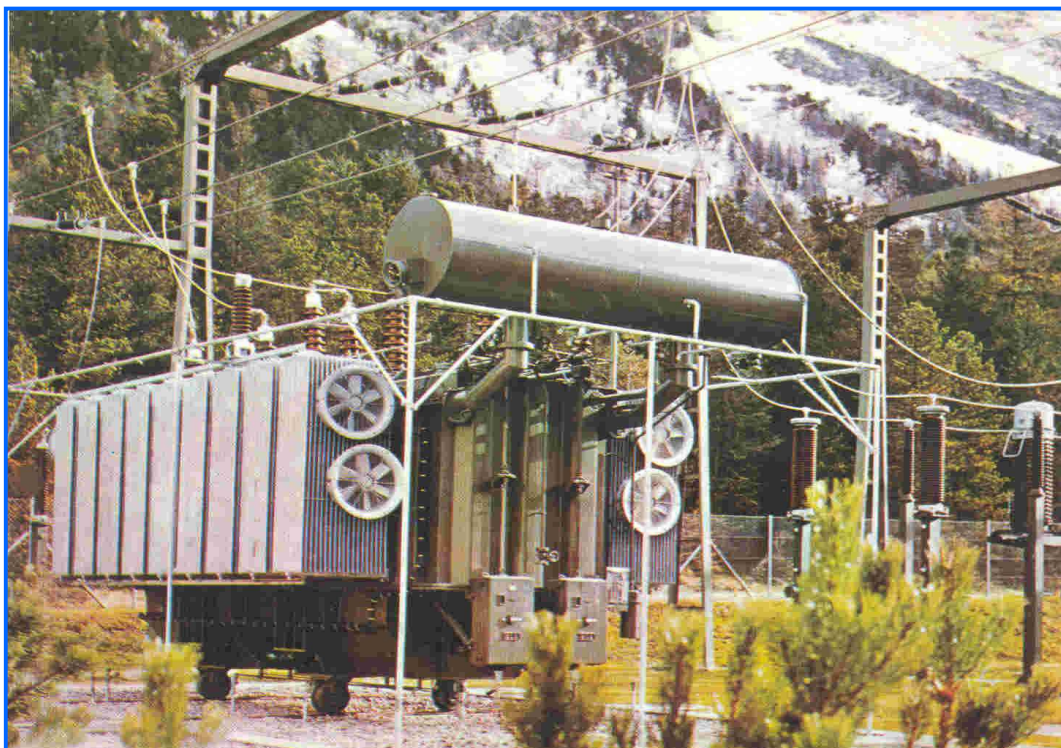
شکل ۵-۱ ترانسفورماتور قدرت فشارقوی با توان 80 \text{ MVA} و ولتاژ 63/11 \text{ KV}
