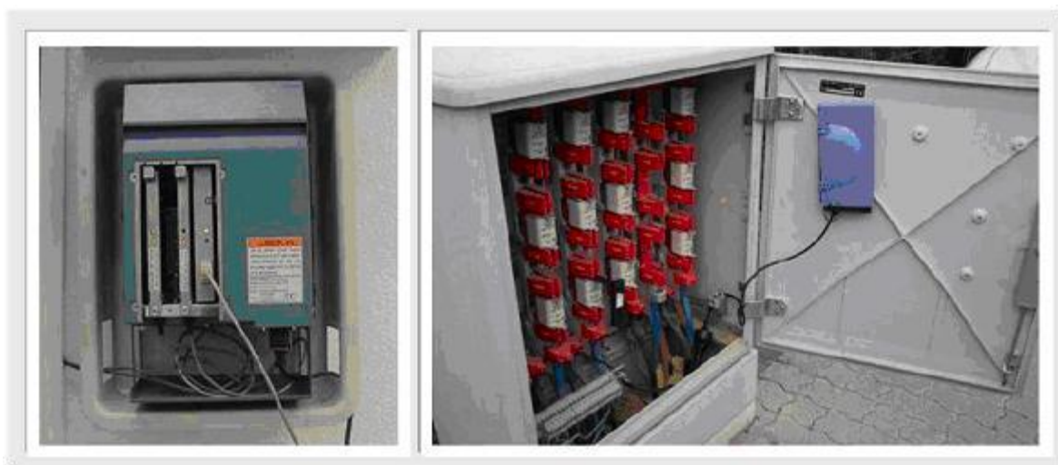
شکل ۲-۴: نمونه‌ای از دو تکرار کننده در اتاق کنترل و کابینت خیابان ۱
