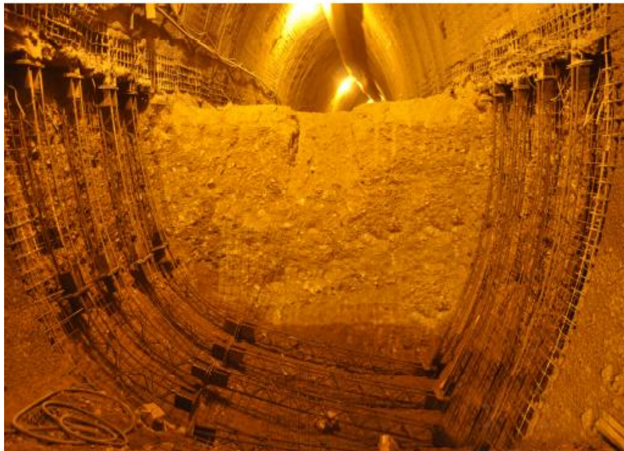
نصب لتیس در قسمت اینورت
